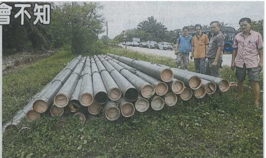
■雷健強(右2)與沙叻小鎮的商民發現路旁放置多個涵管，查詢之下得悉是天然氣輸送管。
